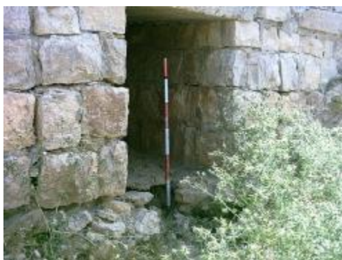
تصویر 2- تهدید آب گذر جاده توسط خندق در منطقه چیلی
